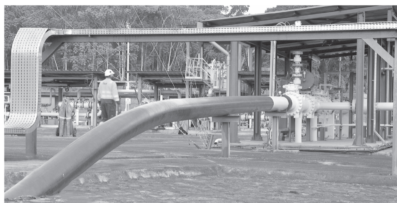
Près de 9 652 millions de pieds cubes de gaz naturel ont été livrés à la centrale de Kribi, correspondant à une capacité utilisée de 149 MW
