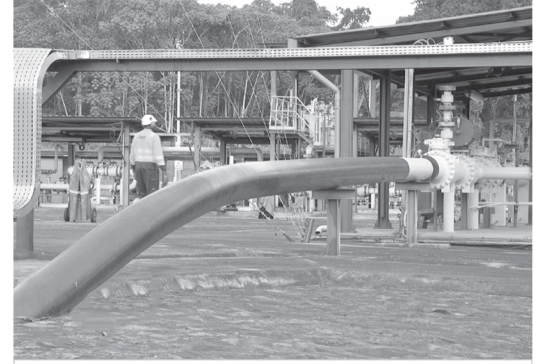
Près de 9 652 millions de pieds cubes de gaz naturel ont été livrés à la centrale de Kribi, correspondant à une capacité utilisée de 149 MW
